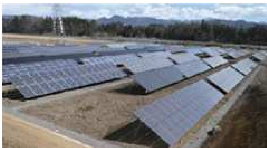
「北杜サイト」太陽光発電システムの一部
